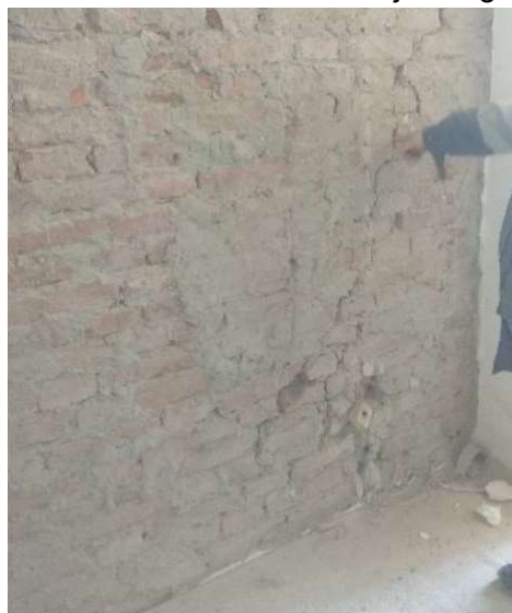
Pukotine širine veće od 10 mm
